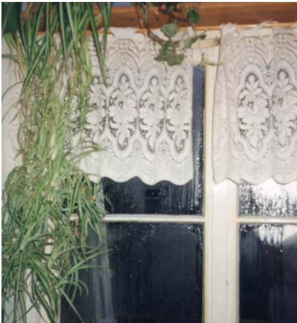
Ablaufendes Kondenswasser an einem einfach verglasten Fenster
